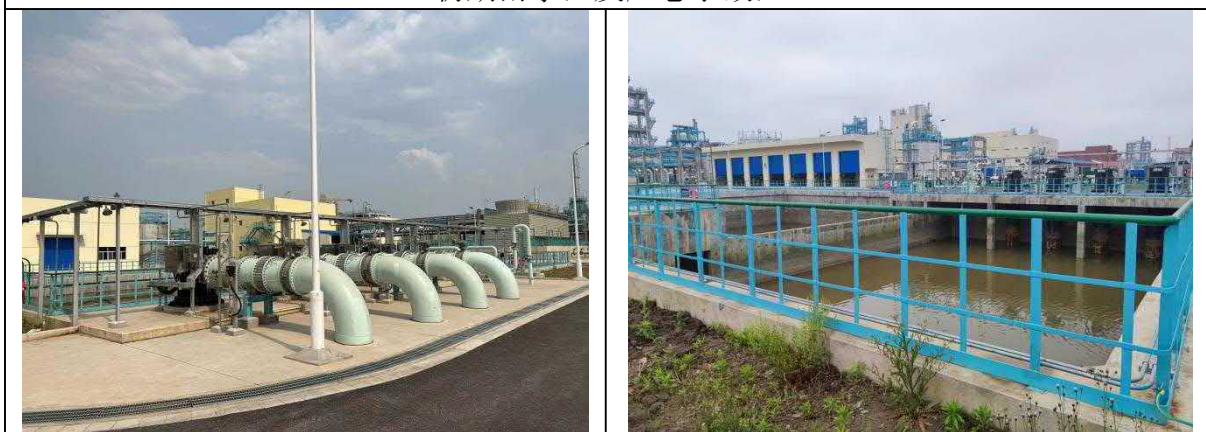
雨水液位控制系统以及提升泵
