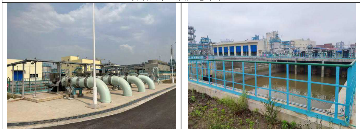
雨水液位控制系统以及提升泵
